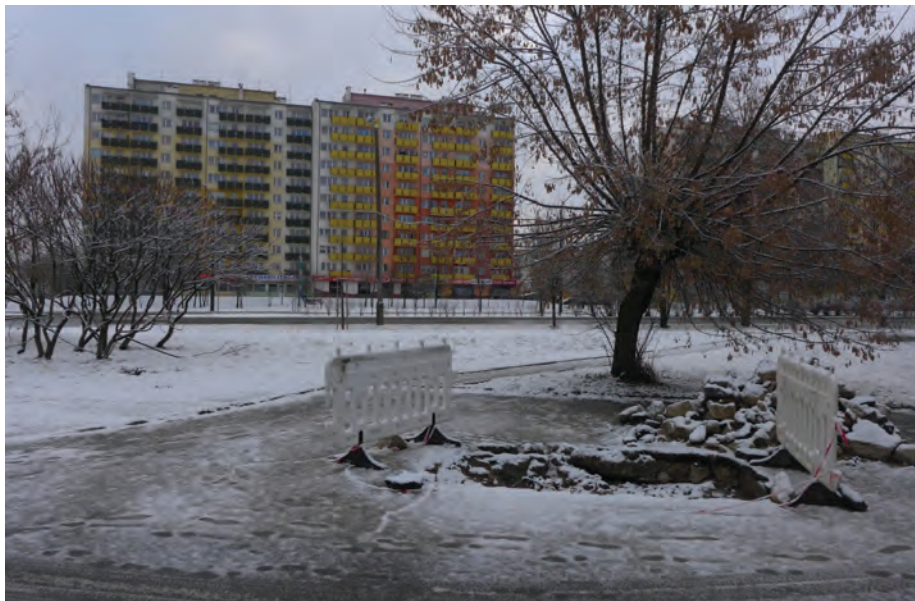
Ryc. 11. Osiedla Akademickie w Radomiu, dziura w nawierzchni parkingu, luty 2006 r., fot. Stanisław Zbigniew Kamiński
