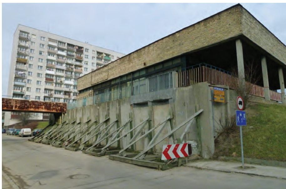
Ryc. 6. Osiedle „Ustronie” w Radomiu, ze ścianą pawilonu handlowego, grożącą zawaleniem, luty 2014, fot. Stanisław Zbigniew Kamieński
